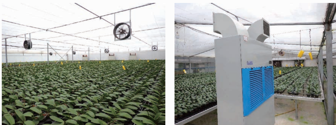
圖5、較高設備投資之生產溫室
